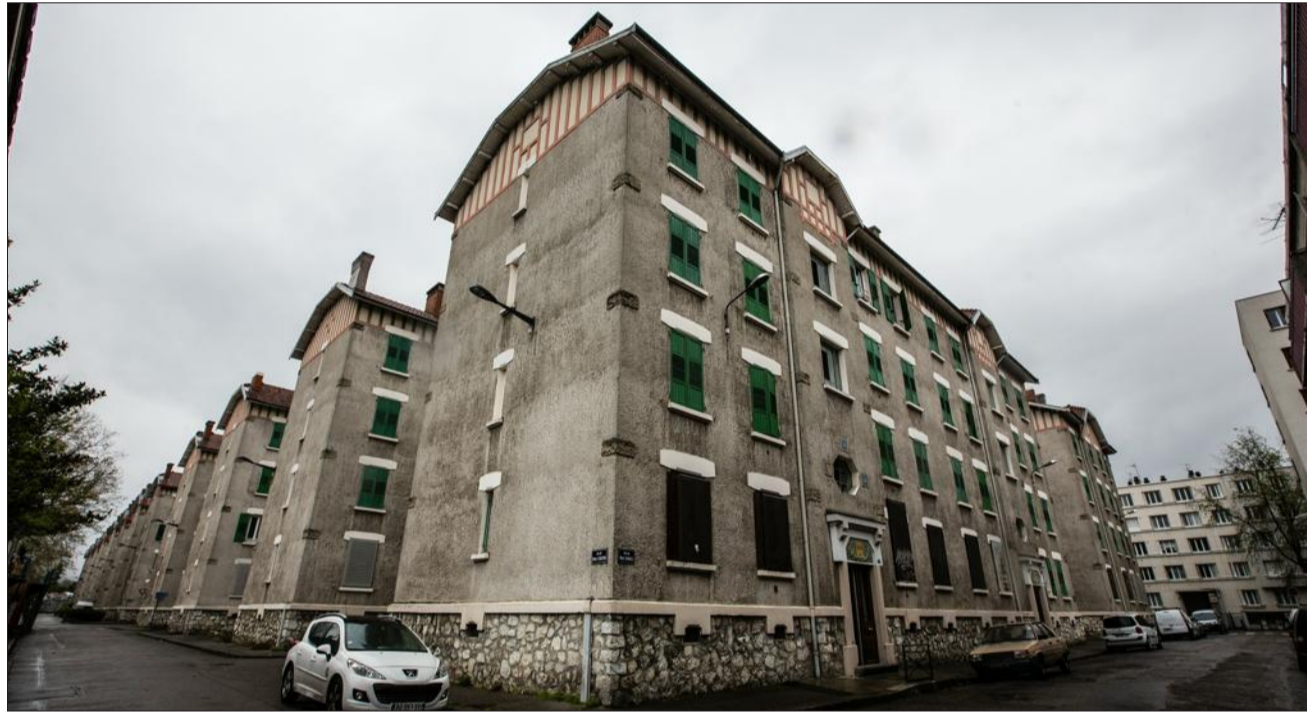
Les trois places publiques que les bâtiments entourent (places Joseph-Riboud, André-Charpin et Laurent-Bonnevay) portent les noms des fondateurs de l'office public départemental d'habitation à bon marché (OPHBM). Photo Le DL/Étienne BOUY
